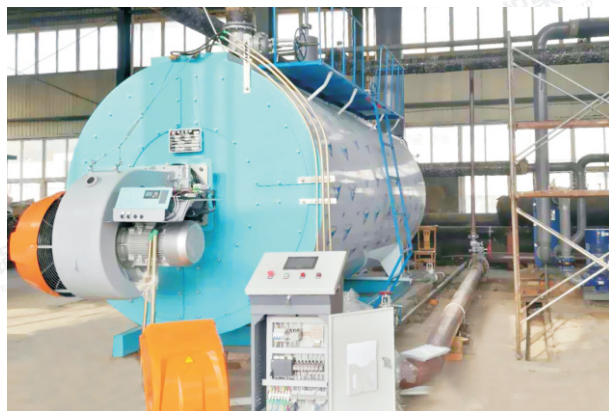
2017.12-5.6MW CWNS5.6-95/70-Q 内蒙古东源水务科技发展有限公司
