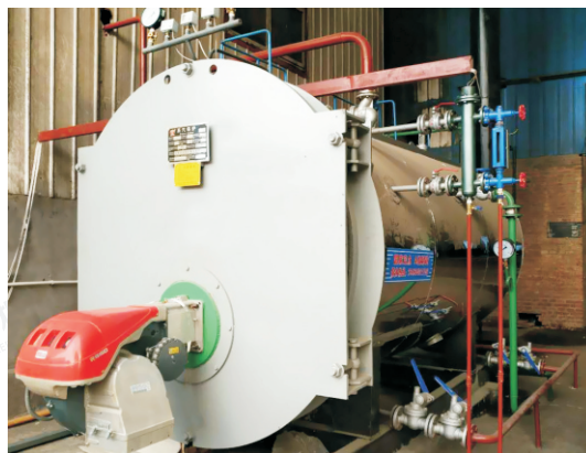
2017.06-2×1.4MW CWNS1.4-95/70-Q 湖南-中铁十五局集团三公司兴县制梁场
